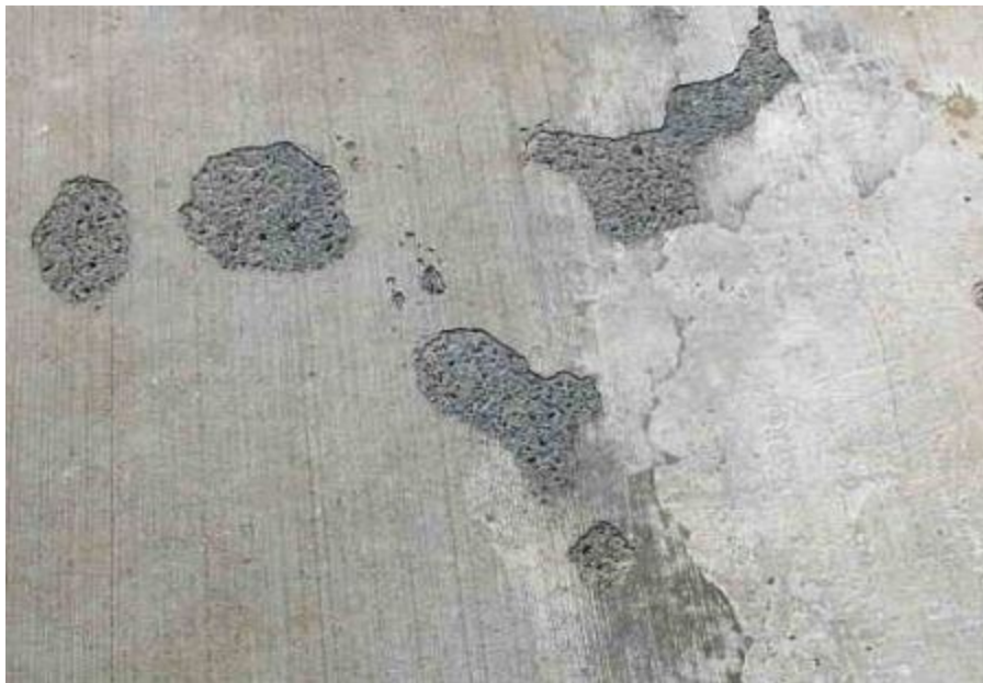
Fig : Concrete Blisters
